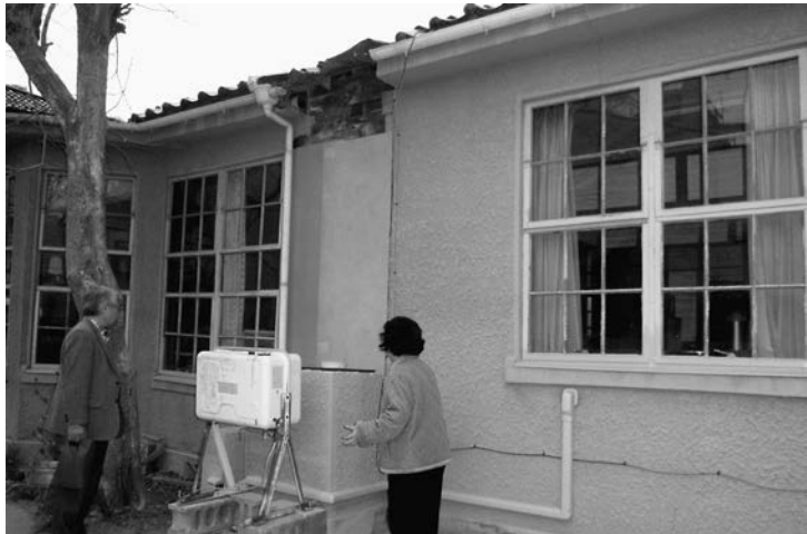
煙突をもぎ取られた福島新町教会
