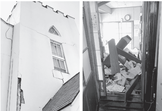
外壁の亀裂が広がった郡山細沼教会
