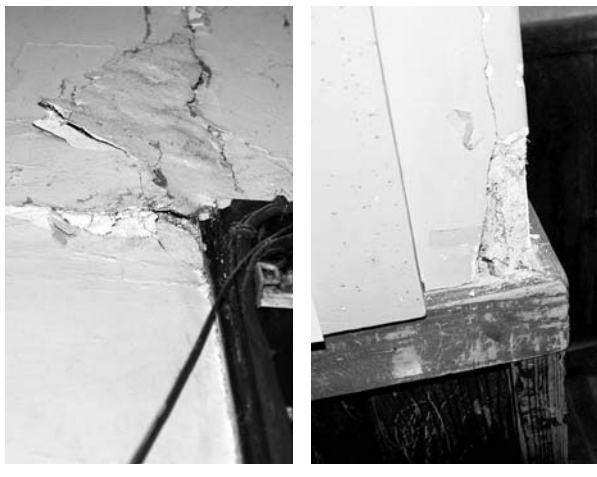
窓枠(左)や柱(右)に亀裂などの被害が大きい
